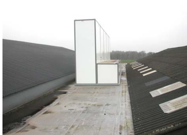
Foto: Een biologische luchtwasser tussen twee stallen. Deze bestaat uit 5 kleinere units.
